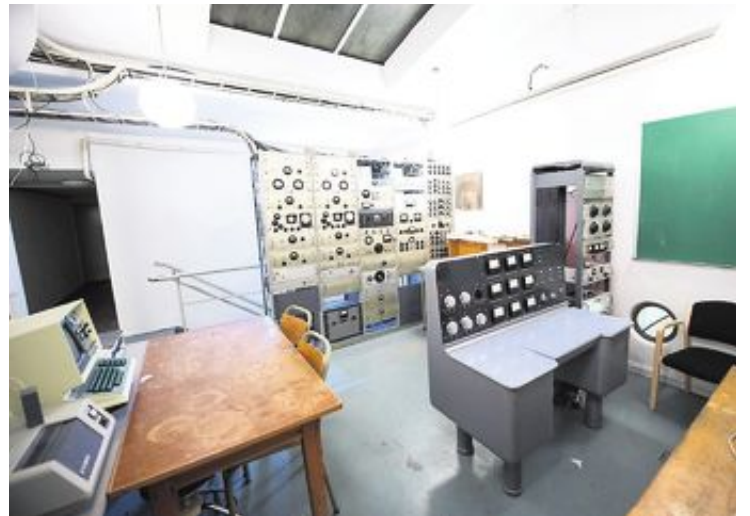
AUTENTISK: I forkant er det eldste instrumentpanelet. Bak er det som brukes i dag når generatoren kjøres.
